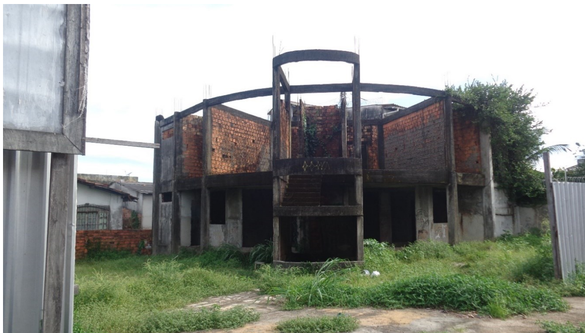
Figura 1 - Edificação abandonada na esquina da Rua Tiradentes com a Avenida General Gurjão, Centro de Macapá-AP
