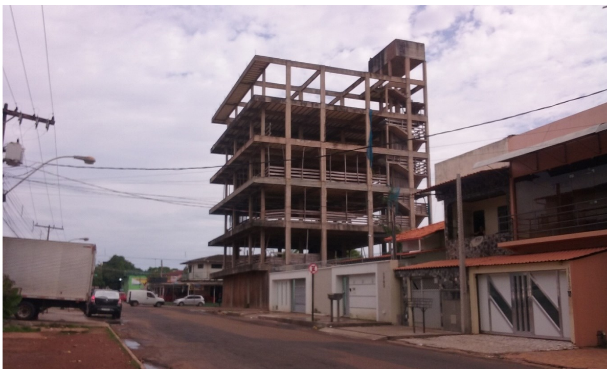
Figura 14 - Edifício inacabado em estágio de abandono funcional encontrado na pesquisa, Rua Jovino Dinoá com Av. Almirante Barroso.
