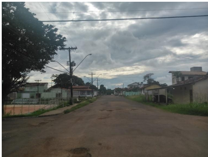
Figura 42 – Trecho da Av. Amapá, com buracos na pavimentação.
