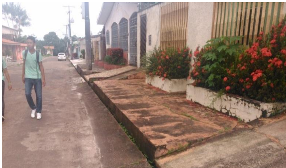
Figura 43 – Desníveis de calçada.
