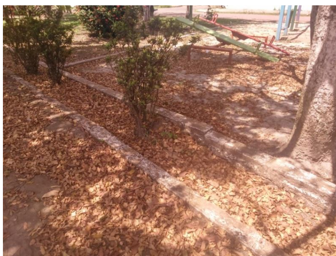
Figura 53 – Pavimentação danificada por raízes.
