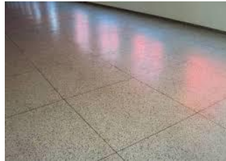
Figura 01: Piso de alta resistência
