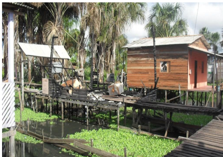
Figura 22: Casa destruída por incêndio.
