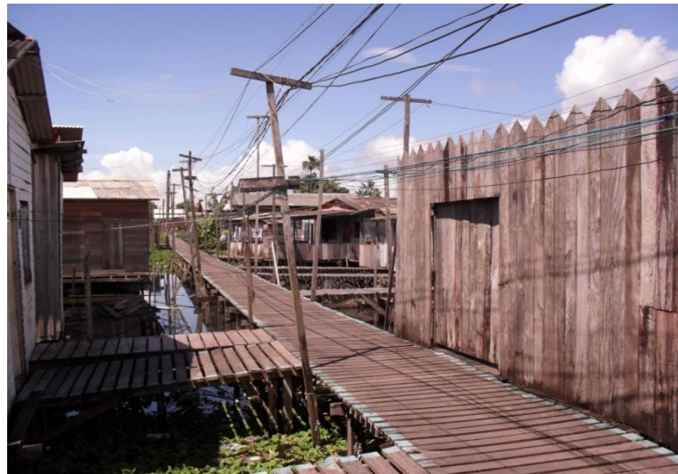
Figura 34: Fornecimento clandestino de energia nas pontes.
