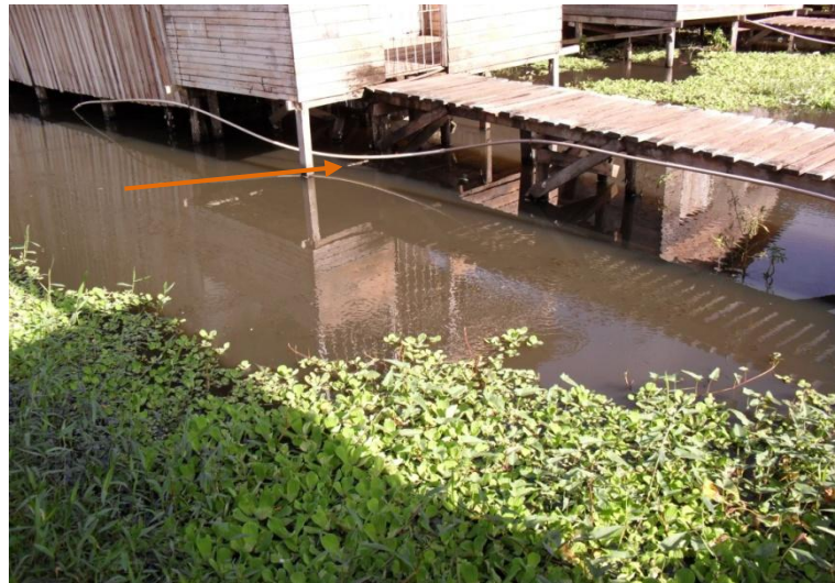
Figura 35: Tubulação nas pontes.
