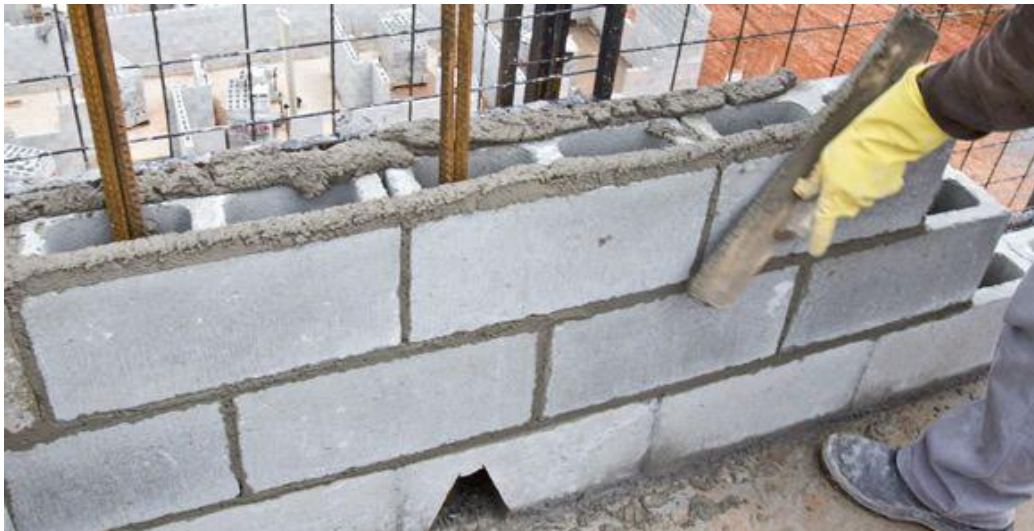
Figura 01: Assentamentos de blocos estruturais. Fonte: www.construcaomercado.pini.com.br .
