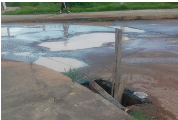
Figura 9 - Esgoto a céu aberto
