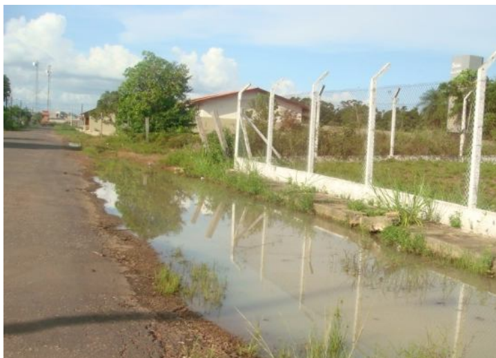
Figura 05: Infra estrutura de drenagem do bairro. Foto: Os autores, 2010.
