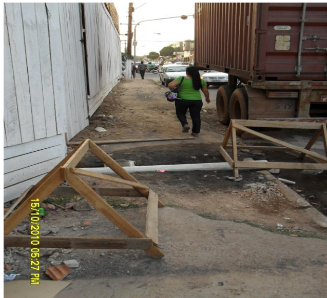
Figura 6: calçada deteriorada e com obstáculos locados abusivamente pelos construtores. Fonte: Bruna Laurindo, Israel Serique, 2010.
