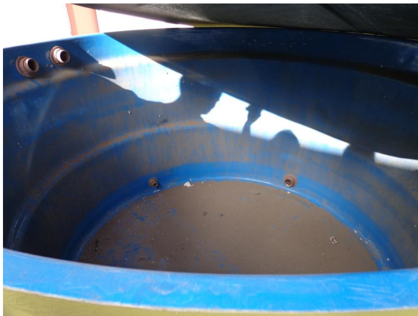
Figura 6: Parte interna do reservatório de água de chuva.
