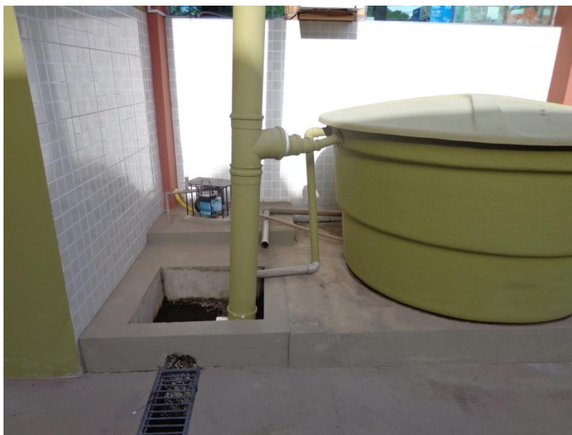
Figura 5: Calha para a captação de água de chuva da edificação e o reservatório de água de chuva.
