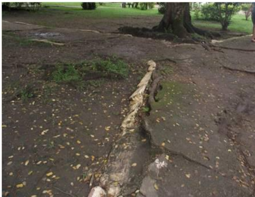
Figura 11 – Desníveis e calçadas deterioradas na praça, impossibilitando a acessibilidade garantida pela NBR 9050/2004. Fonte acervo do grupo.2003.
