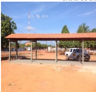
Figura 6 - Passarela sem acessibilidade (atualmente).
