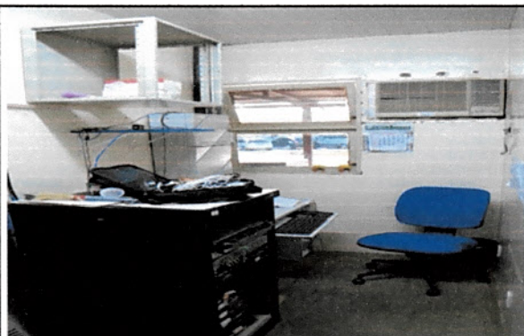
FOTO 04/12: Sala da Central Telefônica.
