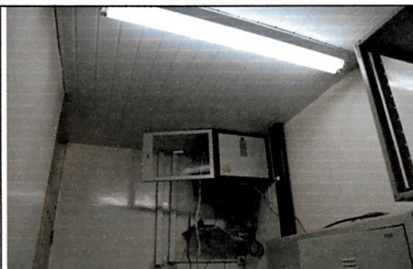
FOTO 06/12: Vista do Switch instalado na sala da central telefônica.
