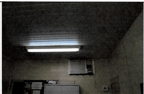
FOTO 10/12: Aspecto geral da iluminação, forro e ar condicionada da sala da Seção de Telefonia.
