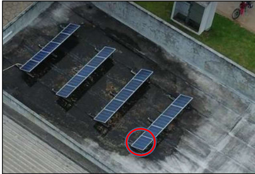
Figura 12: Foto dos módulos fotovoltaicos em cima do Prédio do Bloco de Engenharia Elétrica. Fonte: COSTA; GUIMARÃES JUNIOR (2017)
