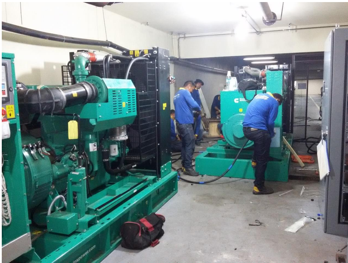
Figura 28 – Geradores posicionados dentro da sala de geração
