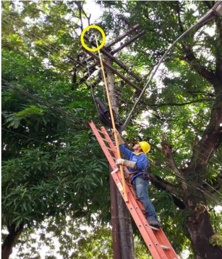
Figura 33 – Abertura das chaves fusíveis
