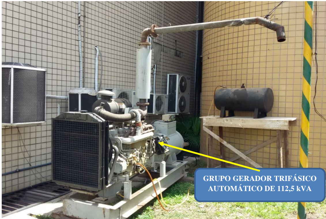
Figura 22 – Grupo gerador alternativo para sala do data center
