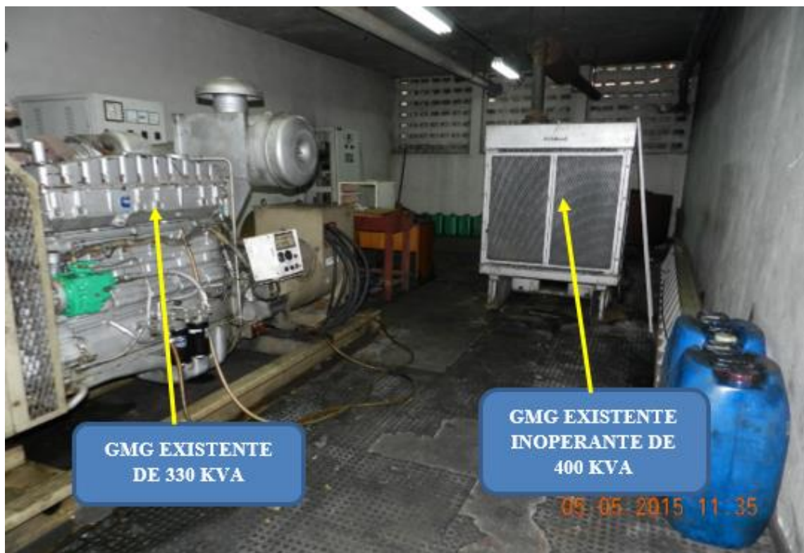
Figura 4 – Dois grupos geradores existentes no prédio do TJAP
