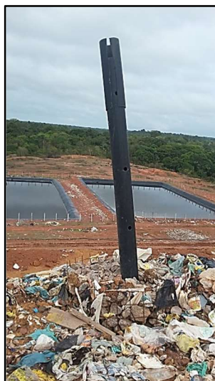
Figura 21 - Drenos de tubo de PEAD do aterro sanitário de Macapá.
