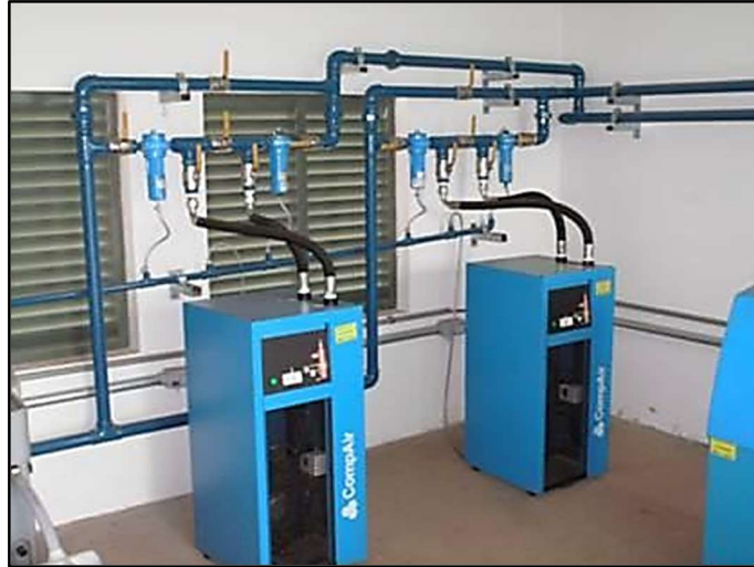
Figura 7 - Compressores para flare.
