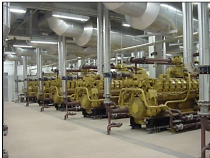
Figura 9 - Grupo Motor Gerador.
