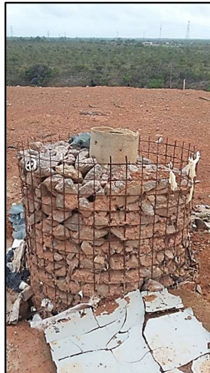
Figura 20 - Dreno do aterro sanitário de Macapá.
