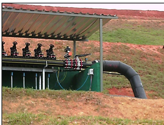
Figura 4 – Tubos de coleta de biogás II.
