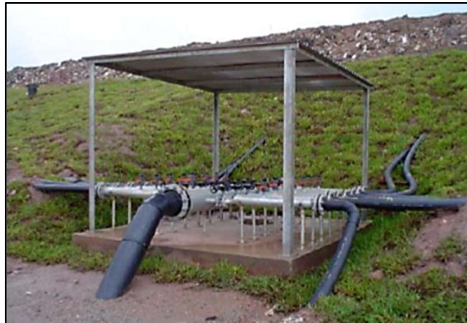
Figura 6 - Tubo de coleta de biogás do Aterro Bandeirantes II.
