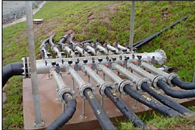
Figura 5 - Tubo de coleta de biogás do Aterro Bandeirantes I.
