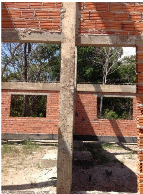
Figura 7 - Segregação do concreto - Pilar 18
