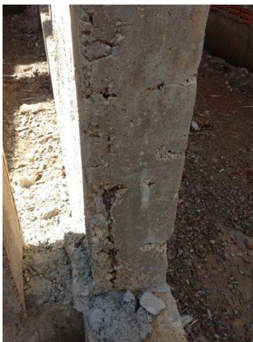
Figura 11 - Corrosão na armadura - Pilar 122
