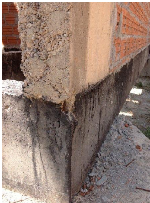
Figura 6 - Segregação do concreto - Pilar 14
