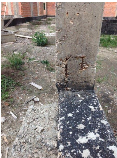
Figura 10 - Corrosão na armadura - Pilar 67
