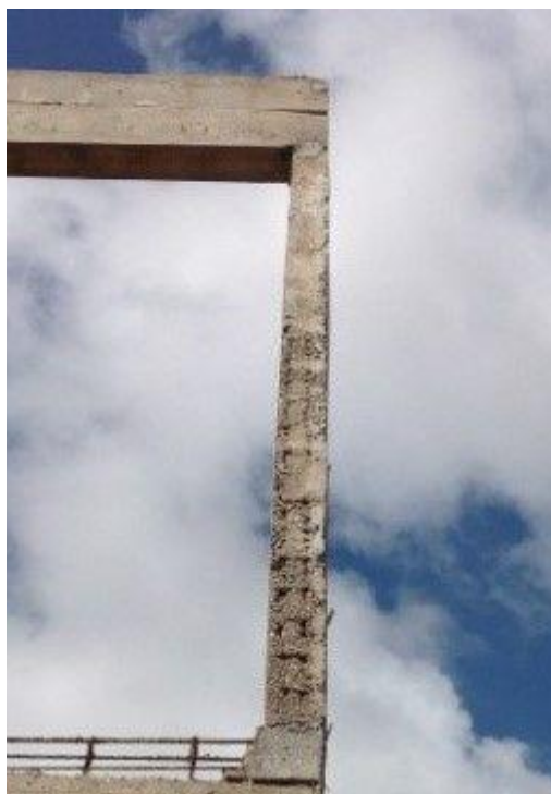
Figura 12 - Corrosão na armadura - Pilar 173
