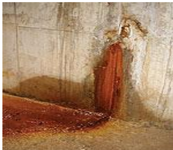
Figura 25 - Infiltração em subsolo
