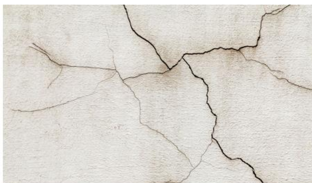
Figura 19 Trinca decorrente de retração da argamassa
