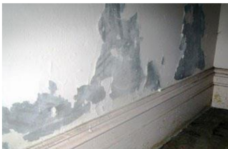
Figura 29 - Descascamento de pintura
