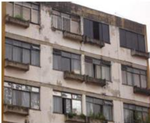
Figura 24 - Bolor em fachada
