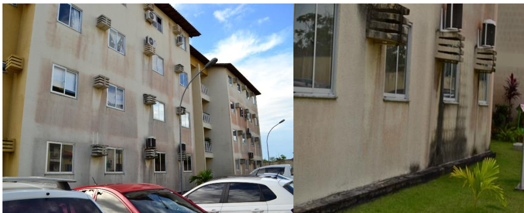
Figura 70 - Representação de manchamentos do Edifício M
