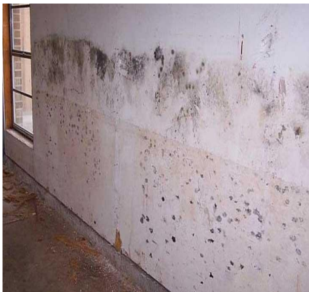
Figura 26 - Manchas devido à umidade
