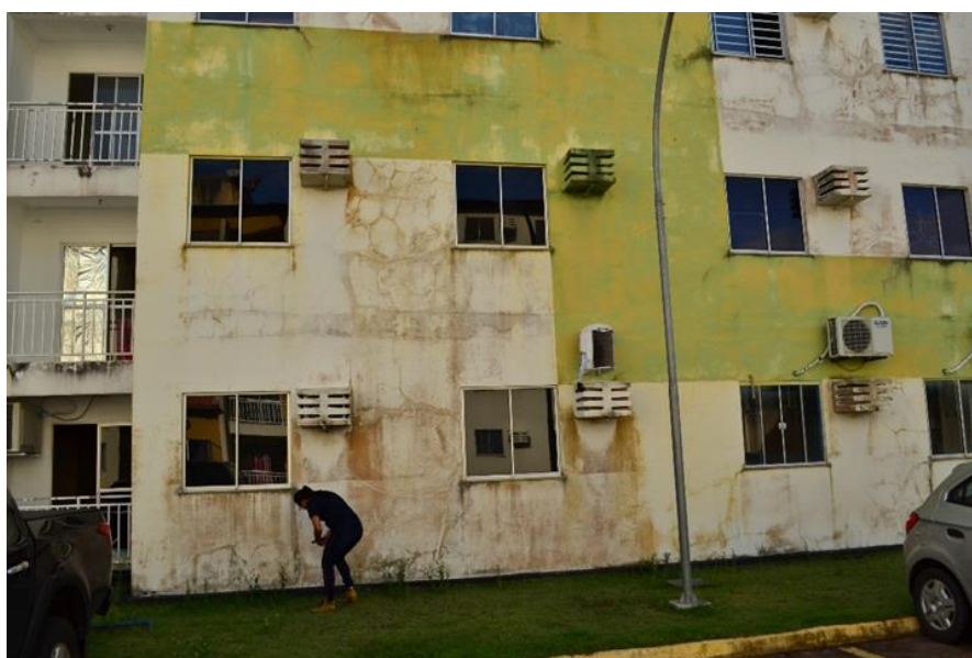
Figura 69- Representação de figuras mapeadas no Edifício E
