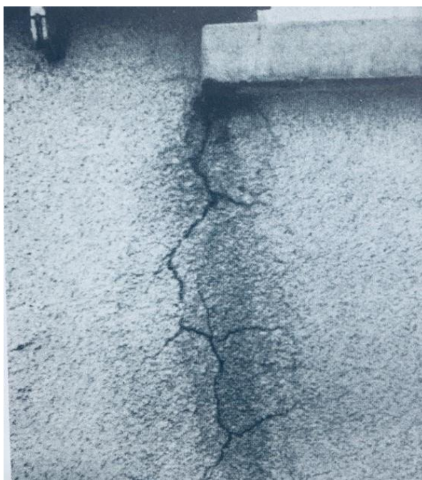
Figura 18 - Fissura causada pela água que escorre lateralmente ao peitoril
