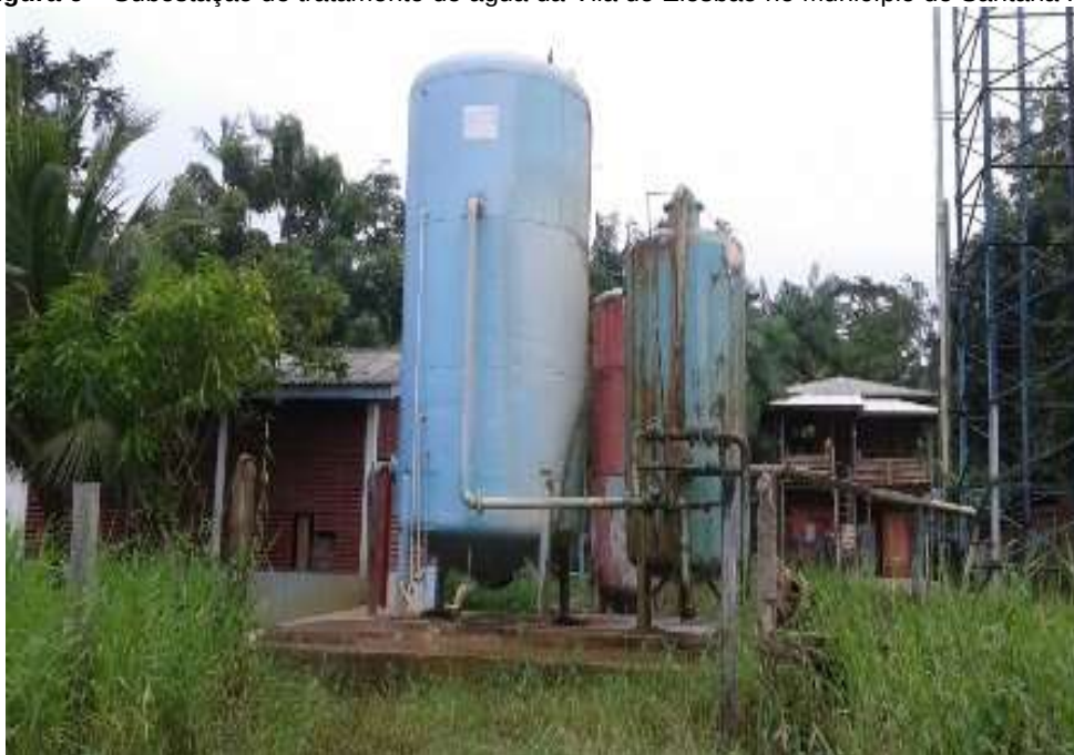
Figura 6 – Subestação de tratamento de água da Vila do Elesbão no Município de Santana-AP.
