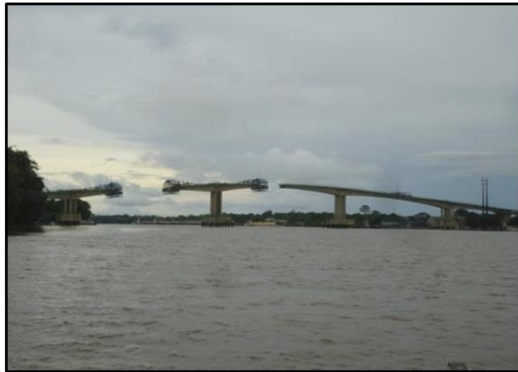
Foto 27: Obra de Construção da ponte sobre o rio Matapi. Fonte: Trabalho de campo, 2015.
