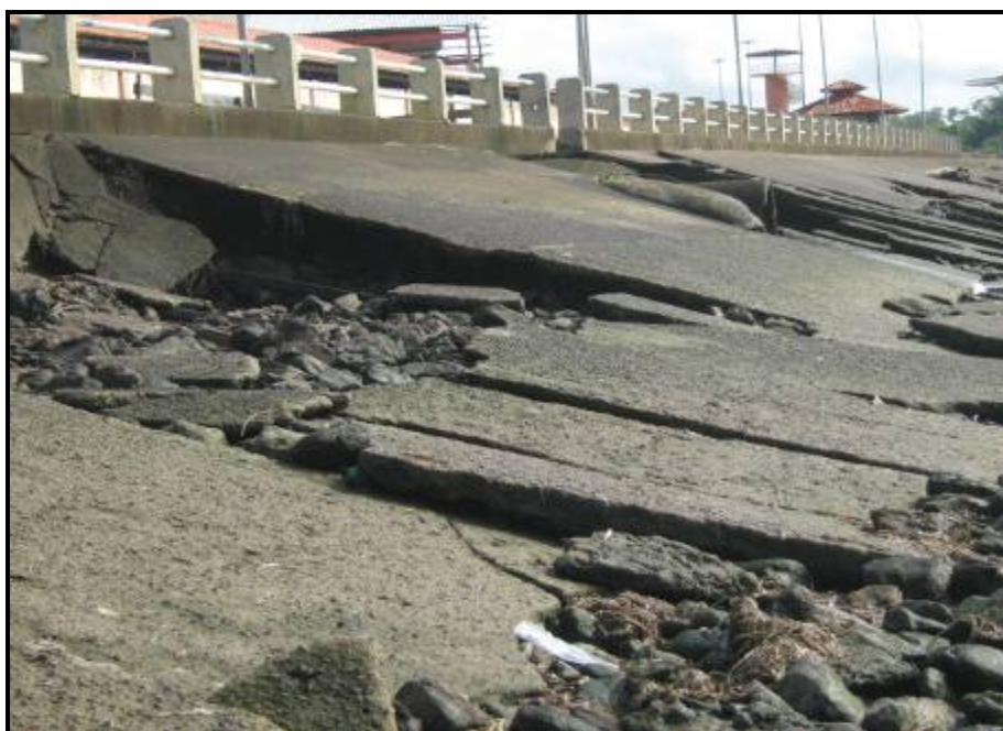
Foto 24 - Erosão no muro de arrimo da orla
