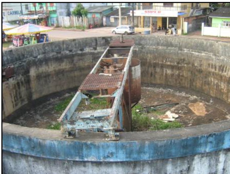
Foto 15 – Ferros sucateados, parte da engranagem da subestação de esgoto.
