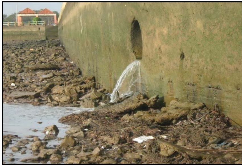
Foto 01 - Despejo de esgoto sanitário na praia do bairro Perpétuo Socorro
