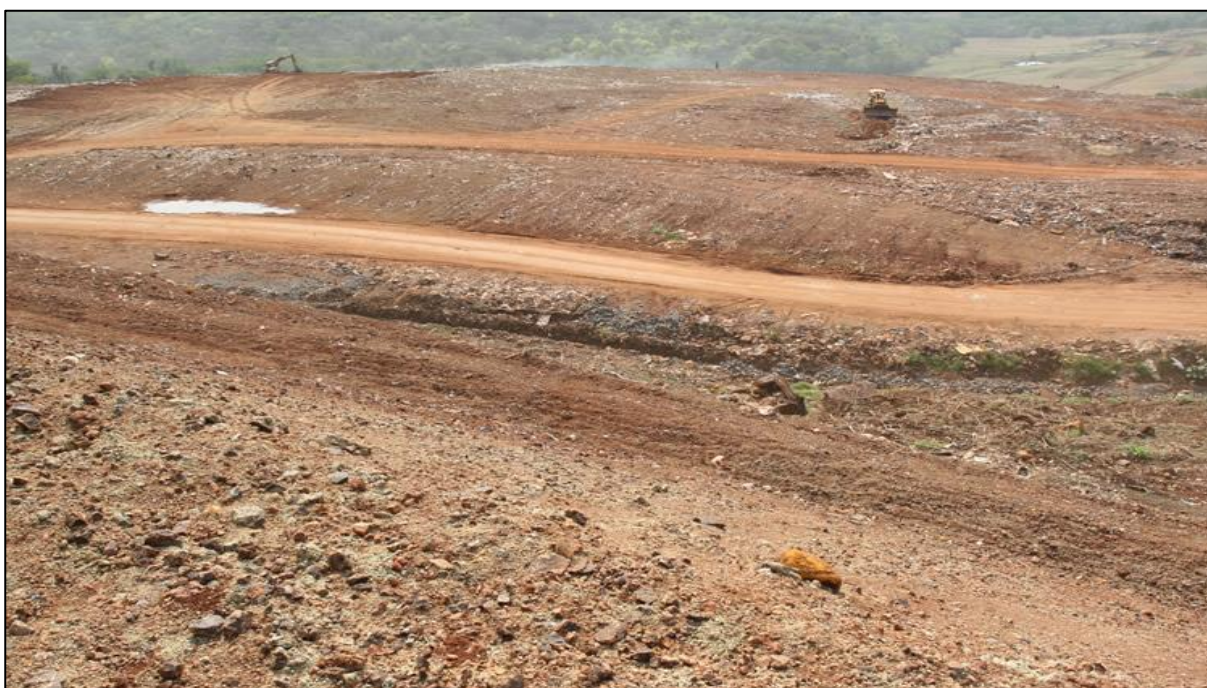
Figura 6 - Disposição de resíduos sólidos em aterro controlado no município de Cuiabá-MT, destaca-se as bancadas com resíduos sólidos confinados e cobertos por aterro.
