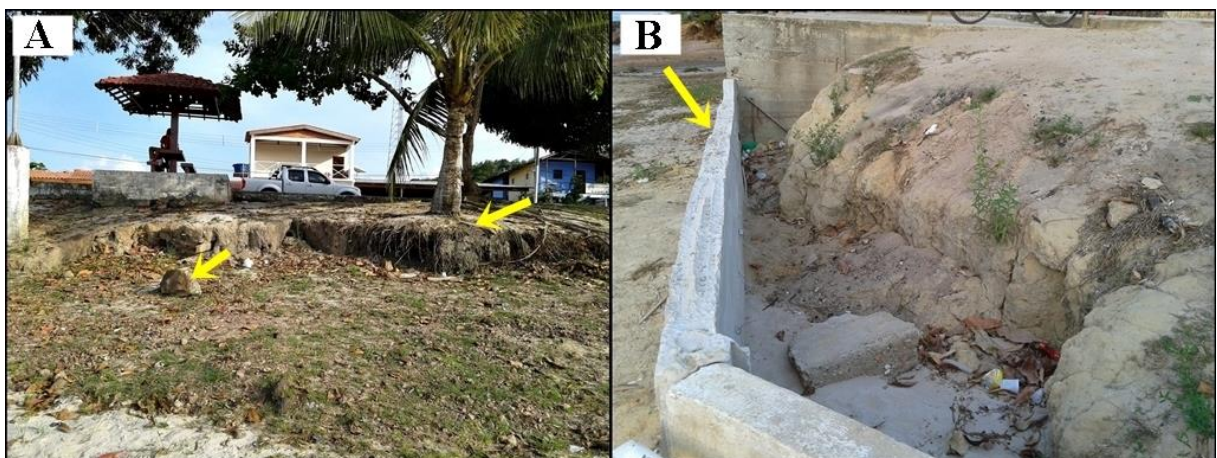
Figura 12 – Erosão dos terraços no setor 1
