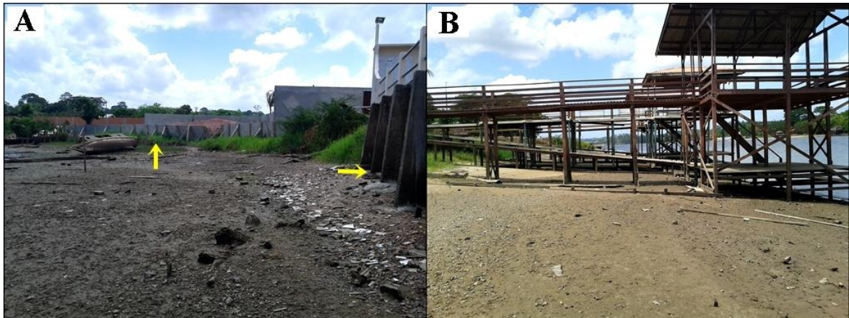
Figura 23 – Aspectos de alterações no setor 4
