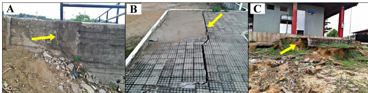
Figura 26 – Comprometimento de estruturas sobre os terraços
