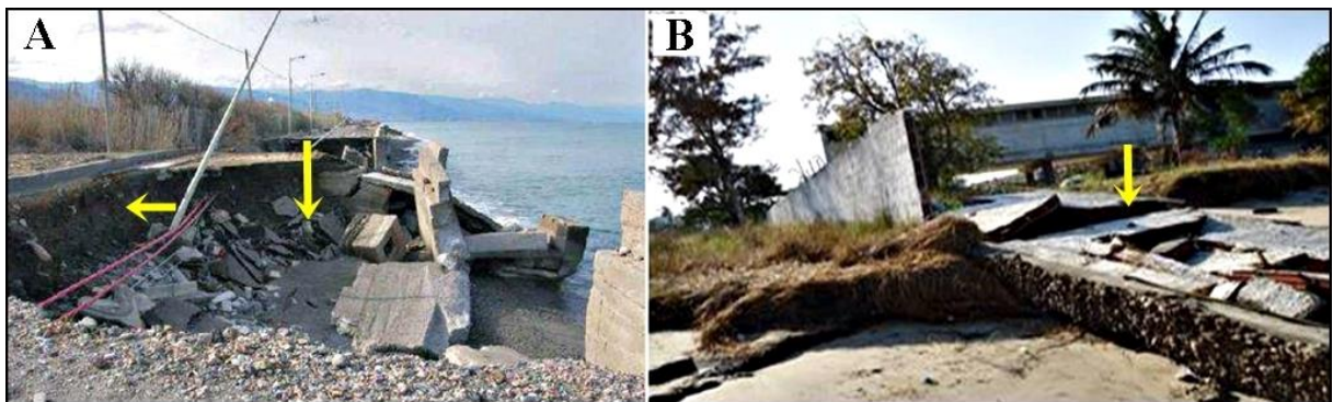
Figura 3 – Consequências dos processos erosivos em orlas urbanas
