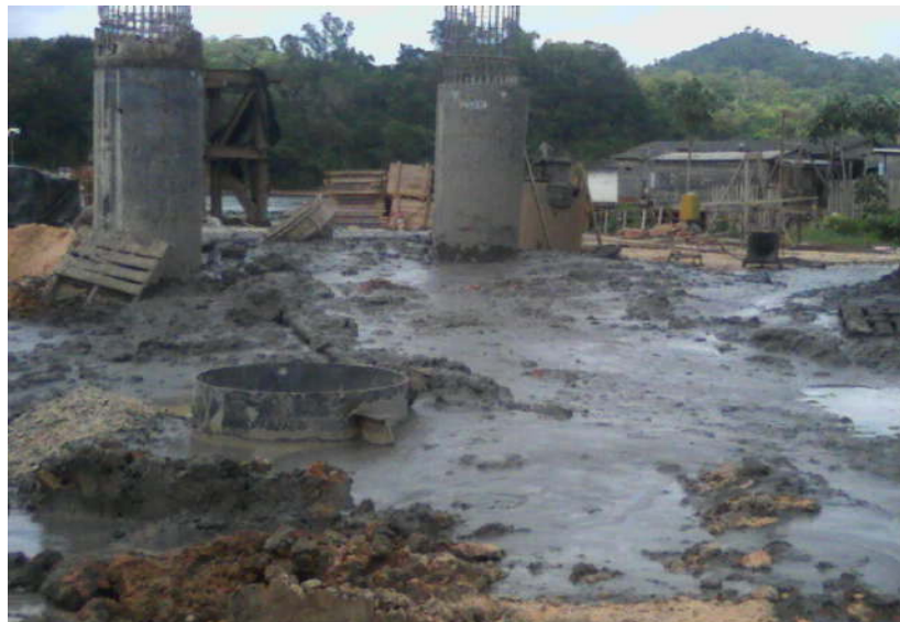
FIGURA 7: Detalhe do resíduo de cimento sobre o solo.
