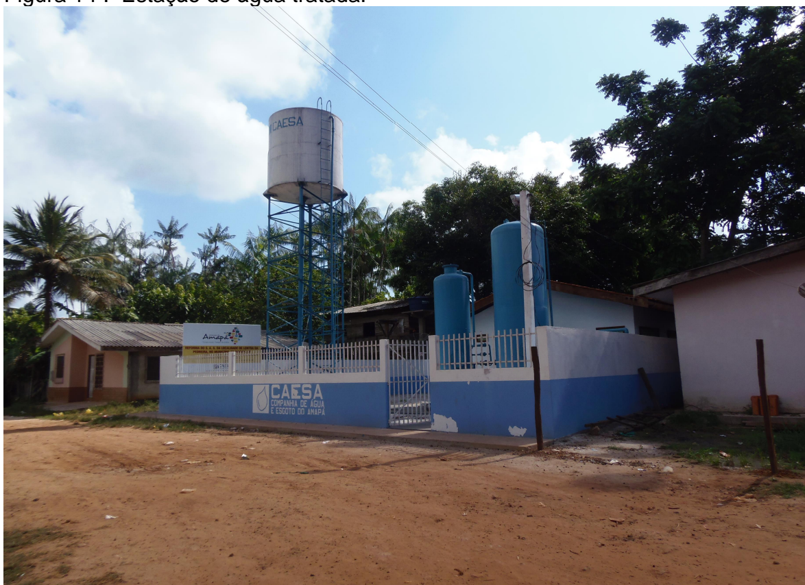
Figura 14 . Estação de água tratada.
