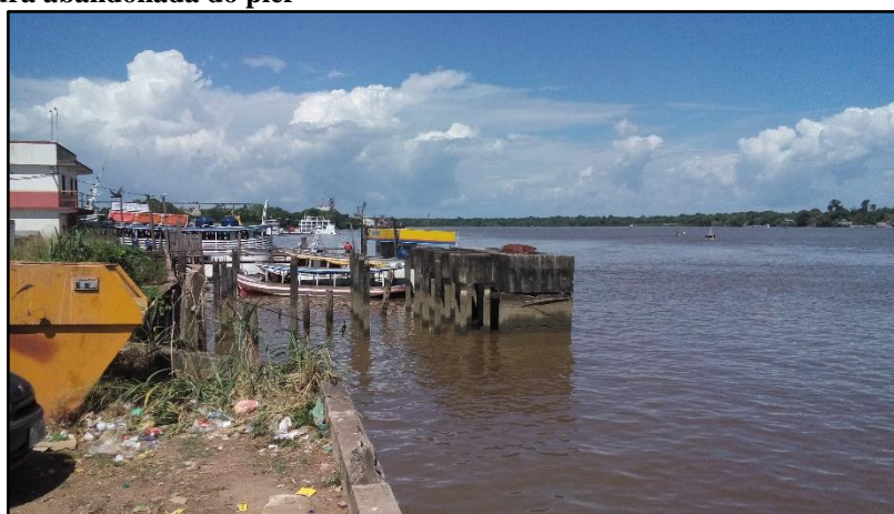
Foto 17 – Estrutura abandonada do píer
