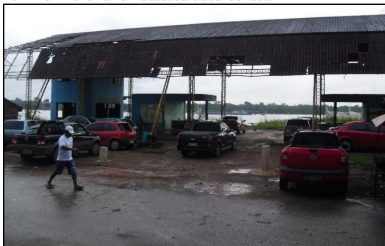
Foto 15 – Obra do Terminal Hidroviário inacabada e abandonada
