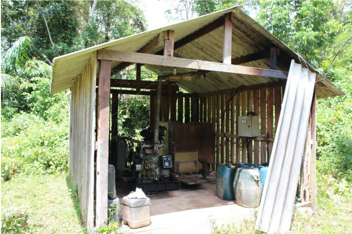
Foto 9: Motor gerador de energia da vila.
