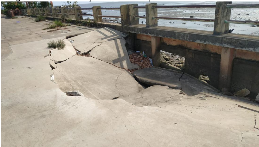
Fotografia 2: Erosão na calçada da orla do Perpétuo Socorro.
