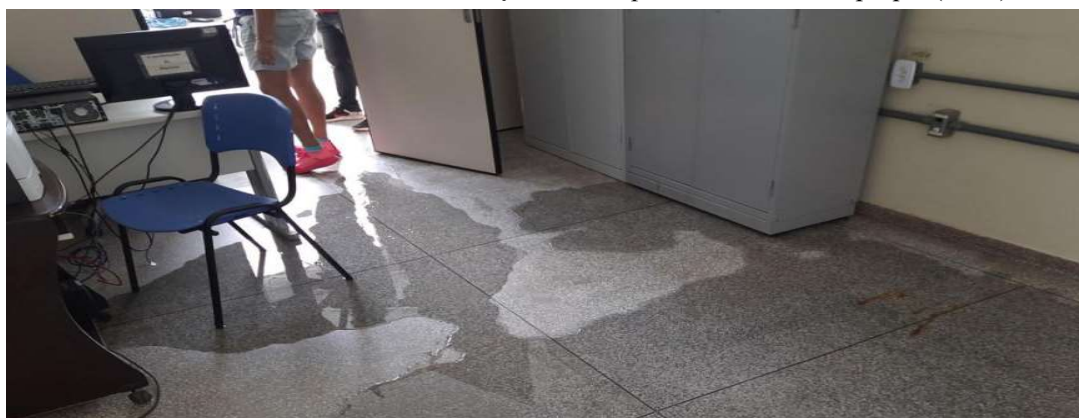
Foto 3 – Piso molhado devido à infiltração no Campus Binacional-Oiapoque (2021)
