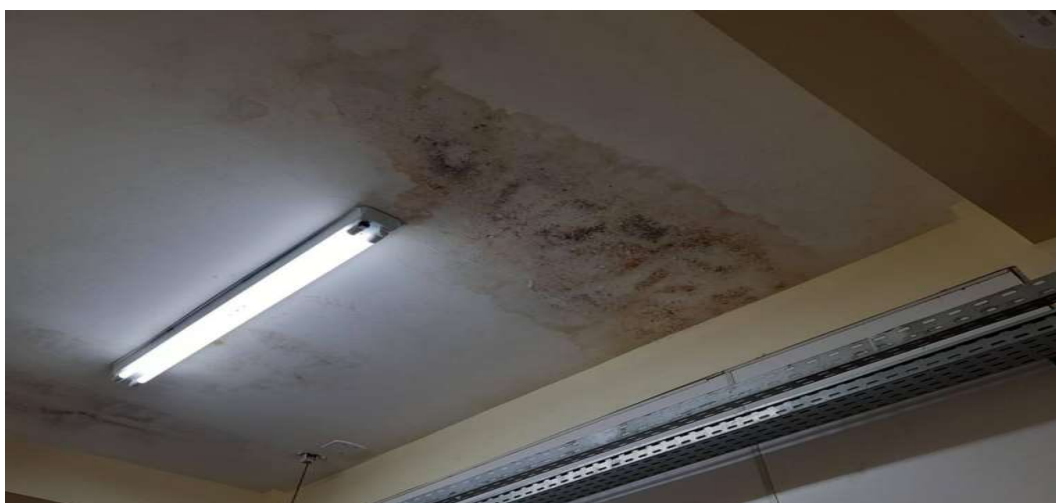
Foto 2 – Infiltração na estrutura do Campus Binacional-Oiapoque (2021)
