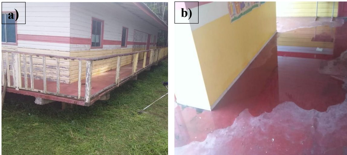
Figura 14- Infraestrutura da Escola Municipal Urubuená. a) Pátio com necessidade de reforma. b) Espaço com infiltrações e goteiras que integra as salas de aula
