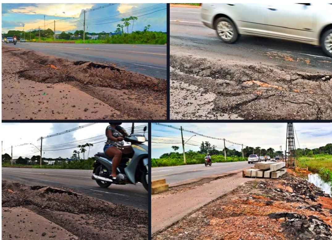
Figura 15 – Deformidades na pista
