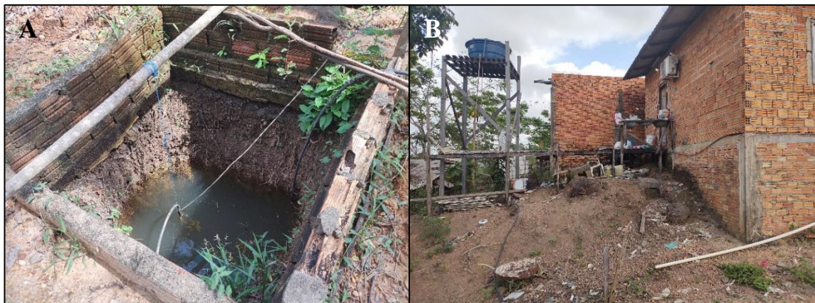
Figura 47 – (A) Poço do tipo Amazonas, sem revestimento, proteção sanitária e tampa, e (B) lançamento de água servida de residência em direção à base da encosta no ponto LJ-11.
