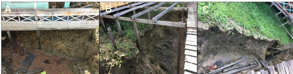
Figura 13 - Processos erosivos na área de proteção ambiental da Fazendinha
