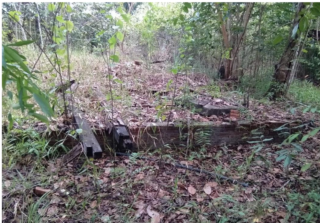
Figura 08: Casa derrubada de Carmita
