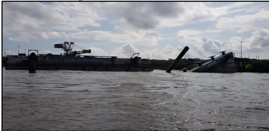
Figura 19: Desabamento do Porto da Zamin
