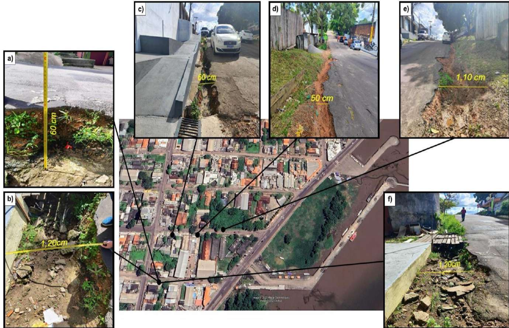
Figura 11 - Processos erosivos atuantes (Ravinas)
