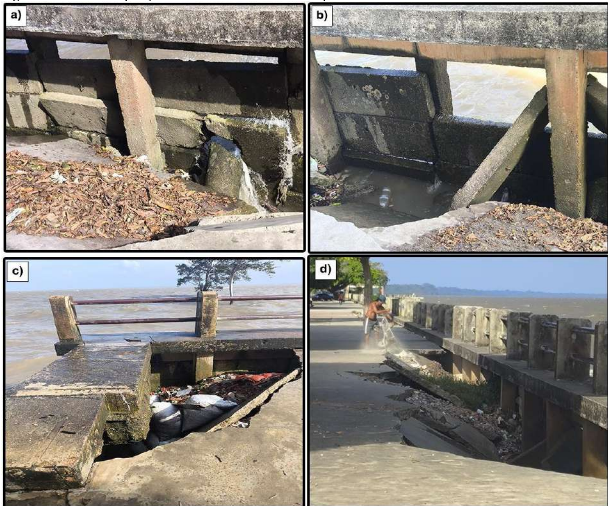
Figura 48 Erosão e Deposição Costeira - Orla do Bairro Perpétuo Socorro
