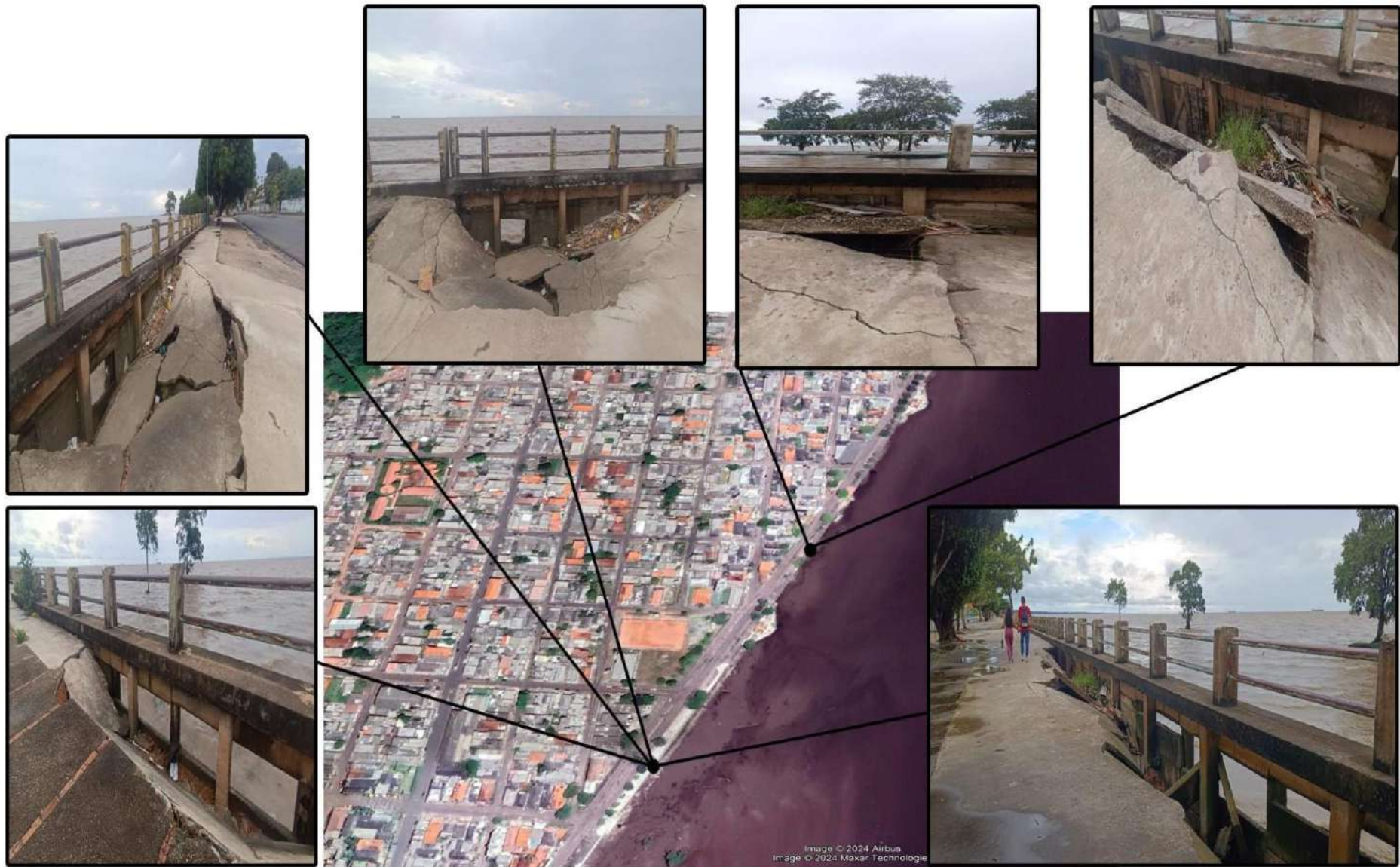
Figura 16 - Erosão fluvial na orla do Perpétuo Socorro
