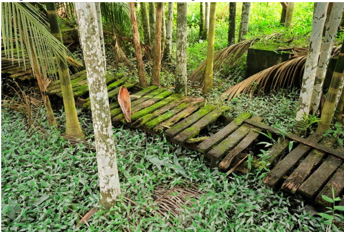
Figura 17 - Ponte sem condições de trafegabilidade na APA da Fazendinha
