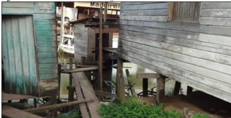
Figura 2 - Unidade sanitária sobre o curso de água
