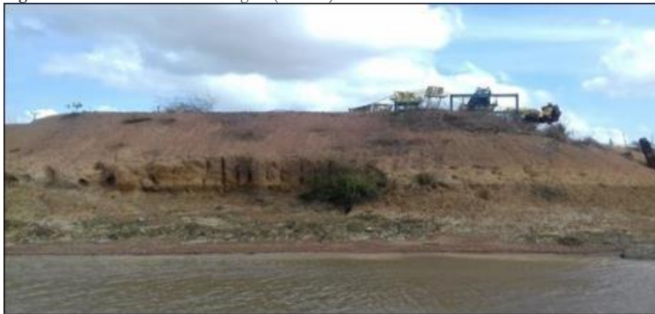
Figura 4 - Ravinas e linhas de drenagem (Ponto 2)
