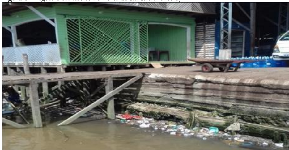
Figura 8 - Esgoto a céu aberto no Porto de Santana (Ponto 6)
