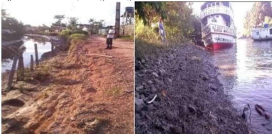
Figura 4 - Erosão e contenção ao logo da margem do Canal da Pedrinhas
