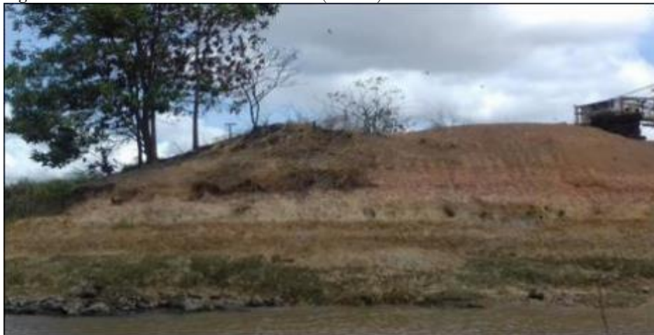
Figura 3 - Erosões na área do Porto de Santana (Ponto 1)
