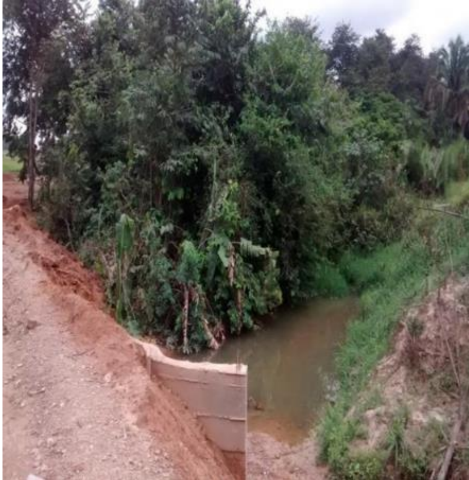
Figura 3 - Degradação às margens do Igarapé Açaizal. São Domingos do Araguaia/PA
