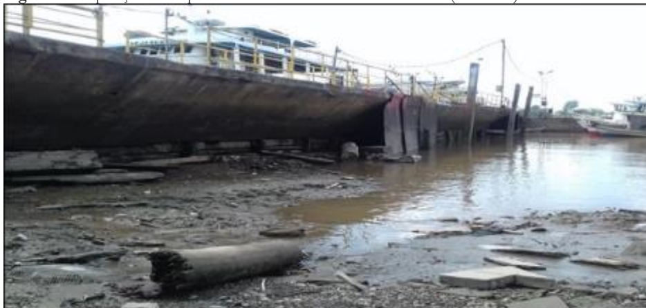
Figura 6 - Deposição inadequada de resíduos sólidos na rede hídrica (Ponto 04)
