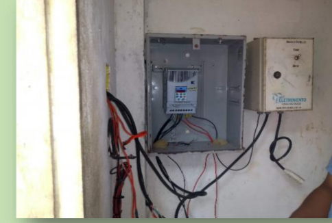
Figura 8 - Quadro de distribuição e Inversor - Sistema Híbrido de Itaubal
