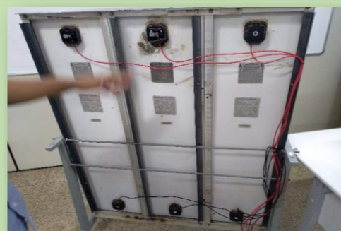
Figura 3 - Instalações das placas solares
